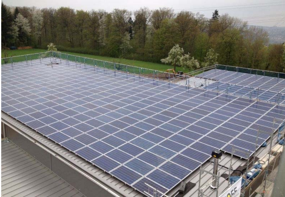
Bauhof Kusterdingen (Jahnstraße 58): 141,5 kWp
